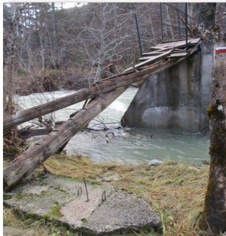
Rampe d'accès détruite
